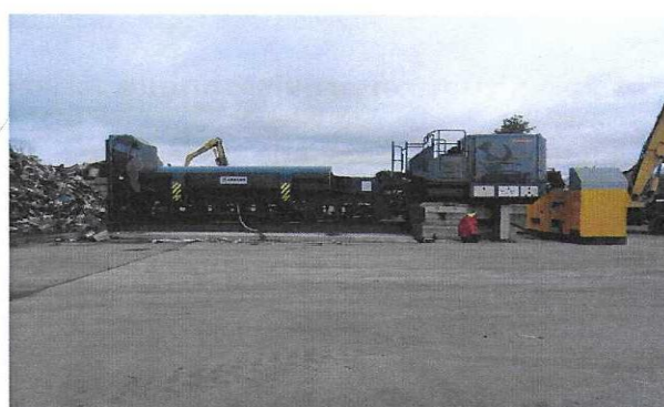
Presse électrique installée en janvier 2022
